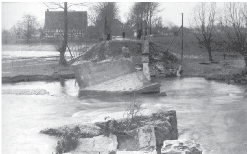
Trümmer der beim Hochwasser im Februar 1909 eingestürzten Almebrücke
